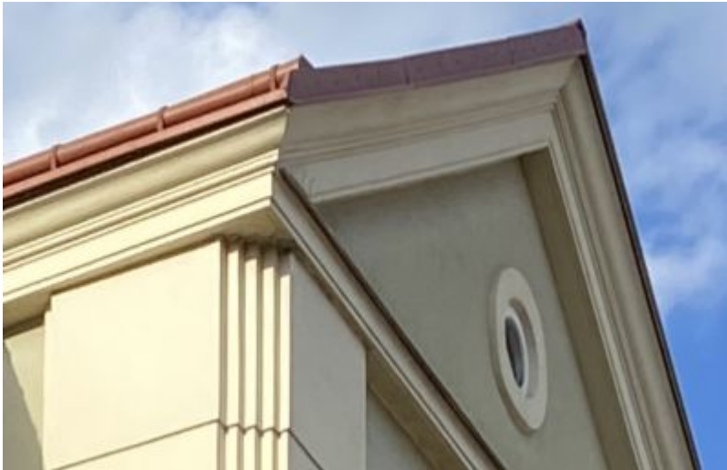
Zbliżenie na ryzalit klatki schodowej elewacji południowej od ul. Sobieskiego. Widoczne rozrzeźbione pilastry narożne, gzyms i obramienie tympanonu. Fot. Ludmiła Łapka
