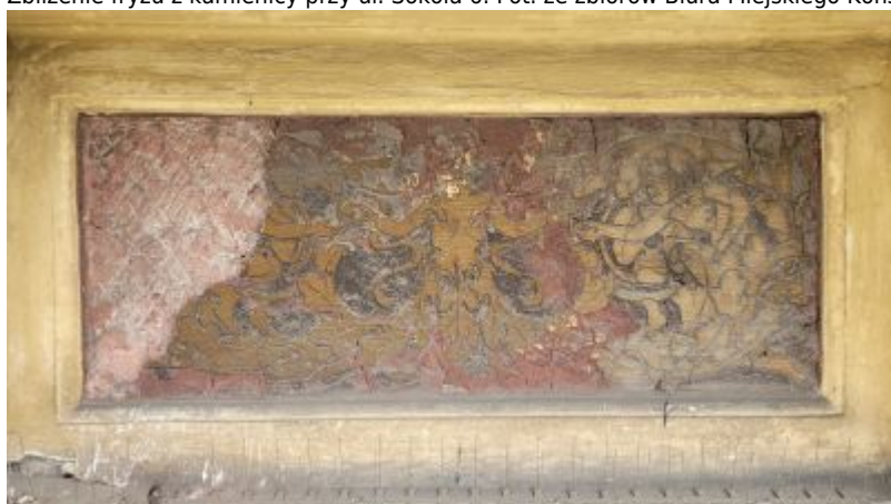
Ul. Sobieskiego 5 - jedna z kwater fryzu. Stan przed pracami konserwatorskimi. Fot. ze zbiorów autorki
