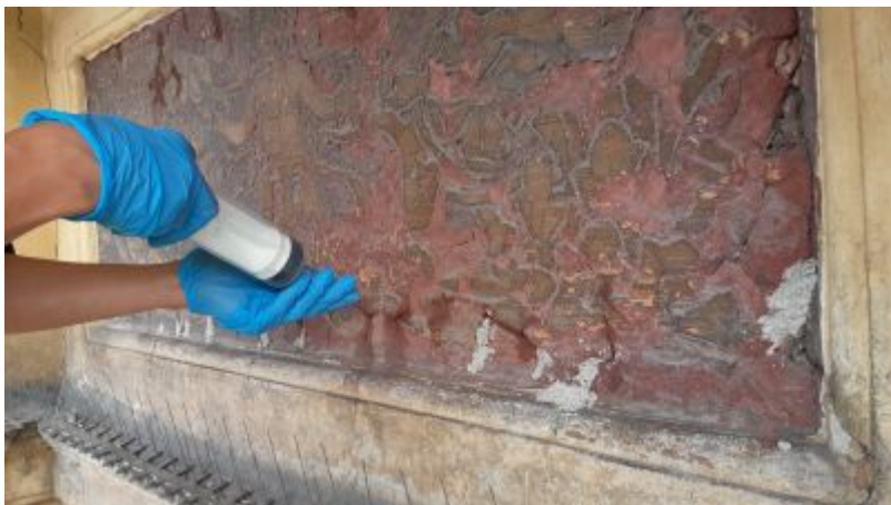
Wykonywanie iniekcji tj. podklejanie odspojonych partii oraz niwelowanie istniejących rozwarstwień (ul. Sobieskiego 5). Fot. ze zbiorów autorki
