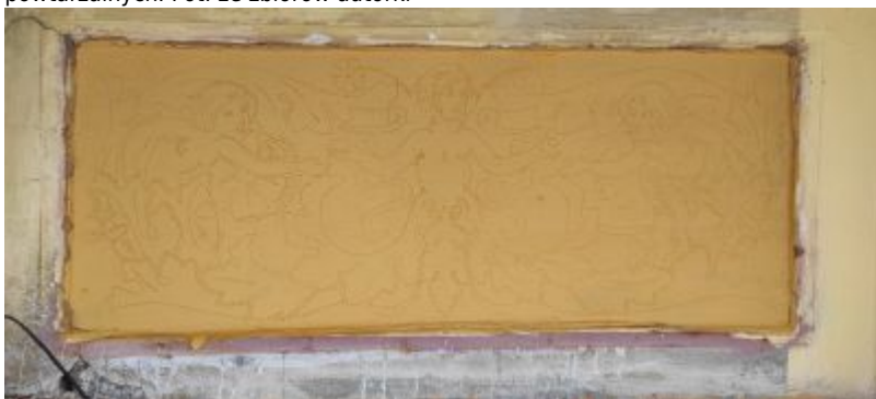
Etap poprzedzający rekonstrukcję sgraffita na obiekcie. Widać rysunek naniesiony metodą przepiórczy na świeżą jeszcze warstwę pobiąły (ul. Sobieskiego 5). Fot. ze zbiorów autorki
