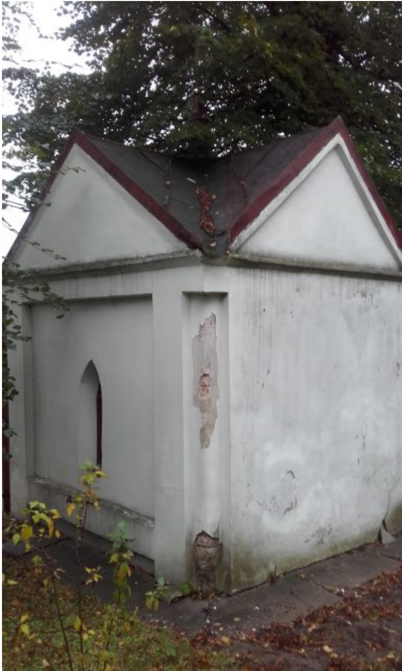
Rok 2014. Ujęcie kapliczki od strony ogrodu. Widać zawilgocenia ścian i wypraw tynkarskich, ich zmurszałość, spękania, miejscowe ubytki i odpajanie od wątku. Fot. ze zbiorów autorki
